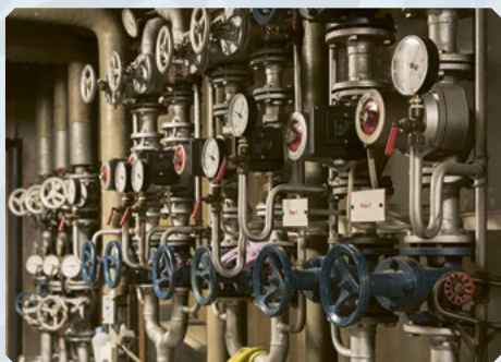
Heizungstechnik im Untergeschoss der Kirche
