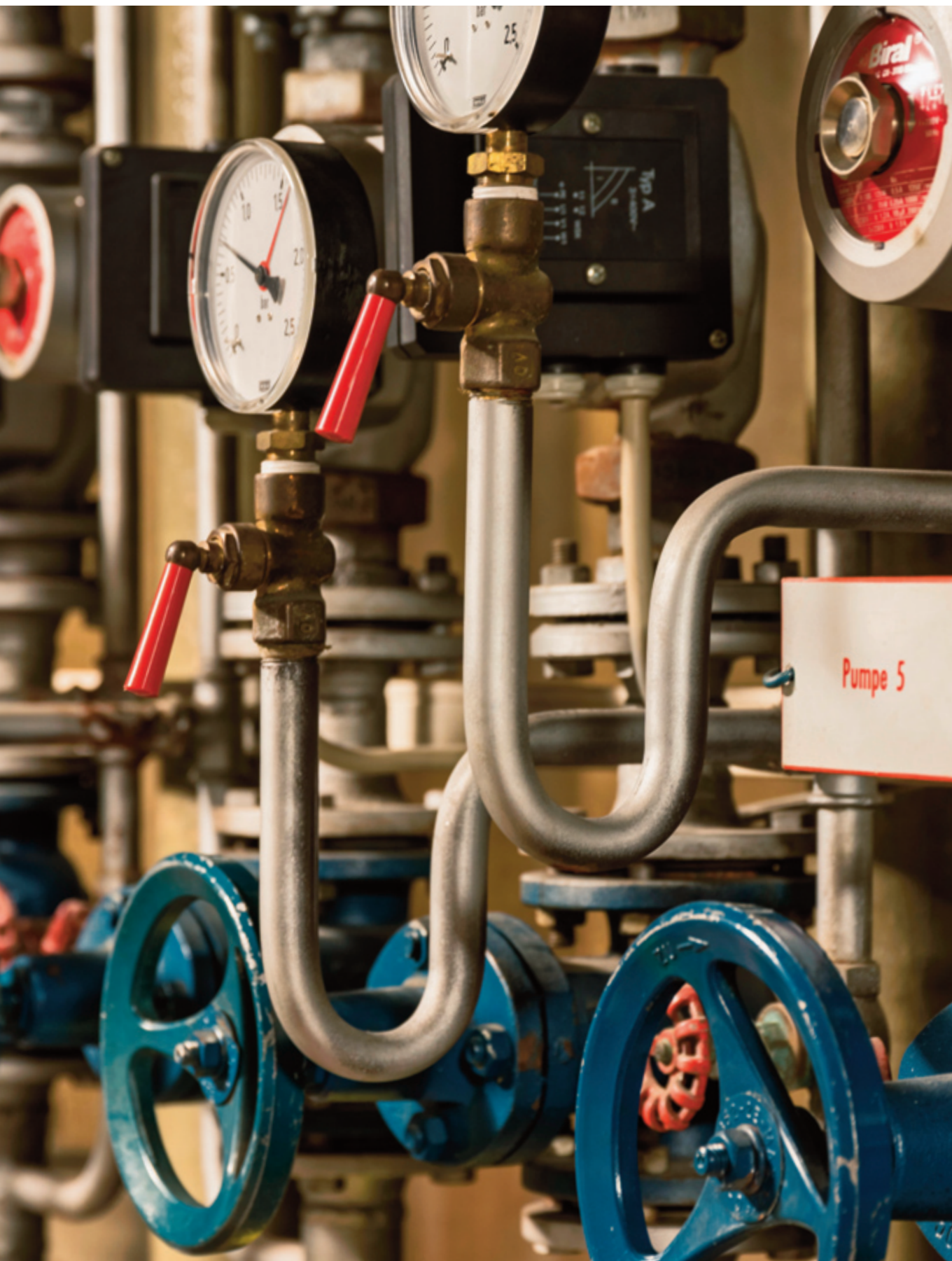
Details der Heizungsanlage
